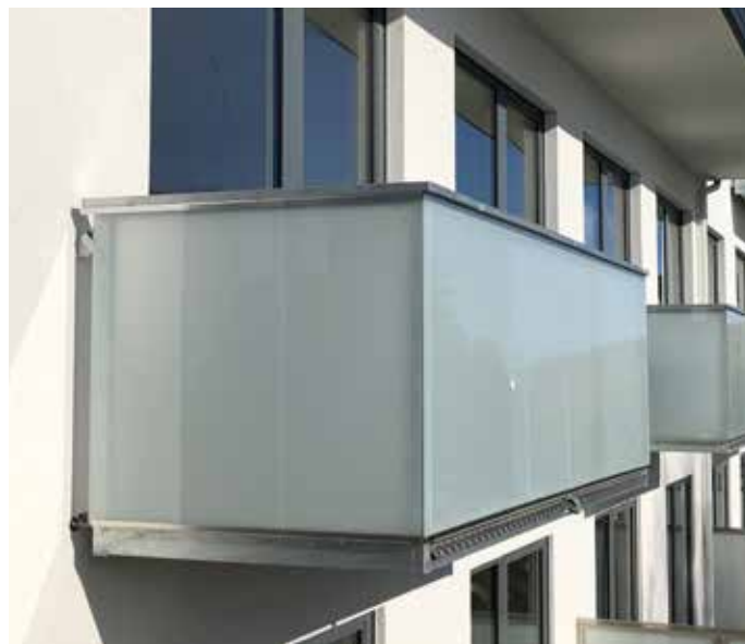
Kotvení balkonu s mezerou
